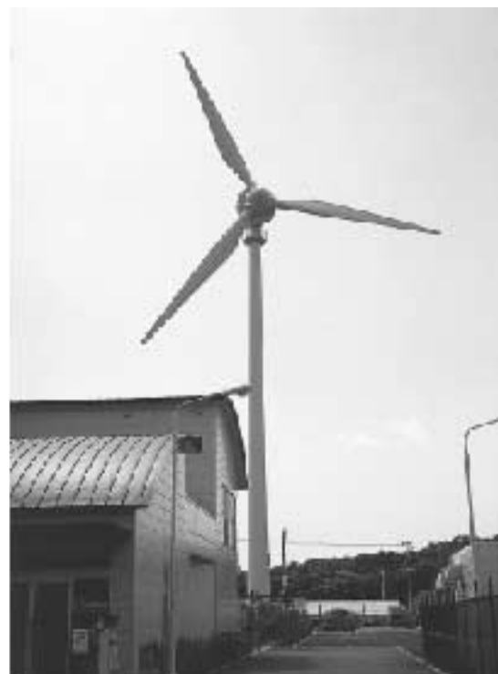
写真2 東電八丈島風力発電所
