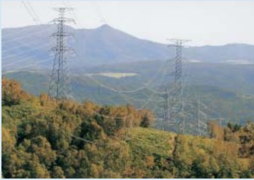
北海道の電力輸送の動脈：275 kV送電線
