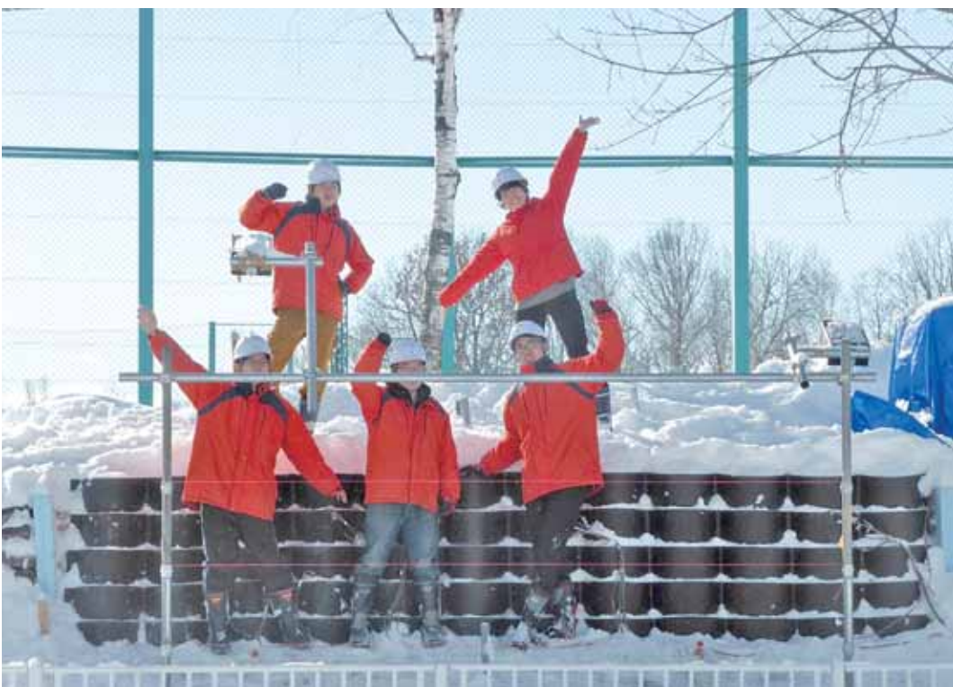
写真1 凍結融解による被害軽減を目的として開発した補強土壁とその施工に携わった研究室の学生達
