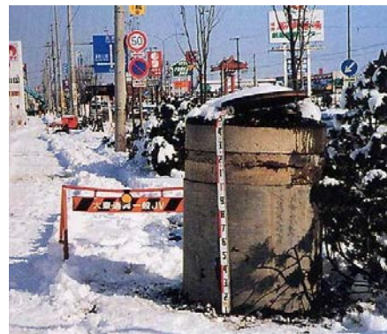
浮いてきたマンホール
