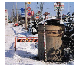
浮いてきたマンホール
