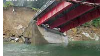
出水時の河床と河岸の浸食により崩落した橋台
